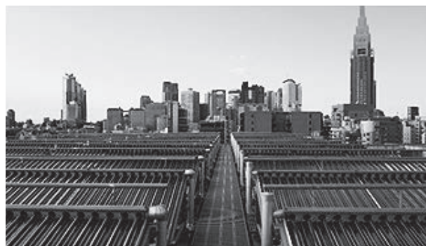
冷暖房に太陽熱集熱器を活用
